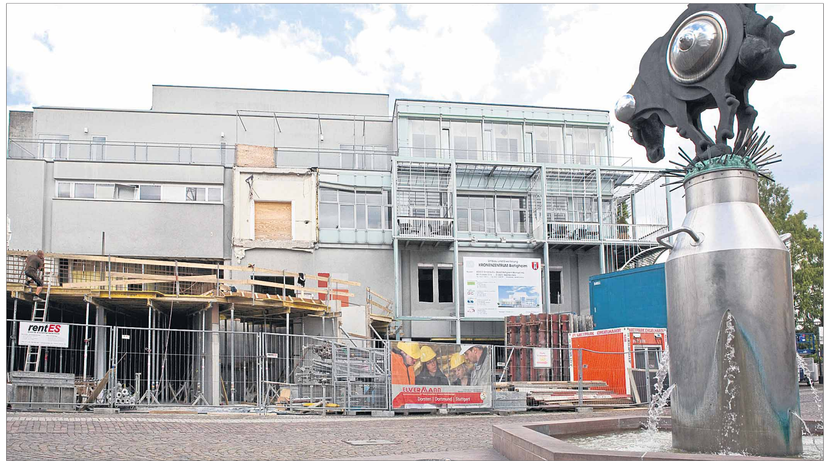
Baustelle Kronenzentrum: Handwerker verbinden den neuen Anbau mit dem sanierungsbedürftigen alten Teil.
